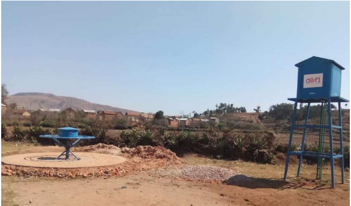
Le dispositif installé : puits, play-pump et château d'eau !
